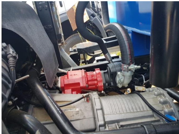
Bomba acoplada a la toma de fuerza
