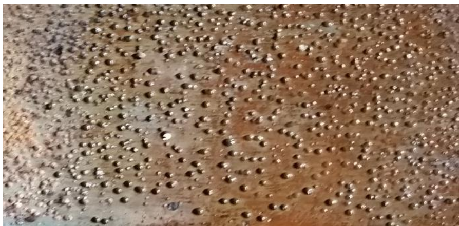
Ejemplo de corrosión galvánica
